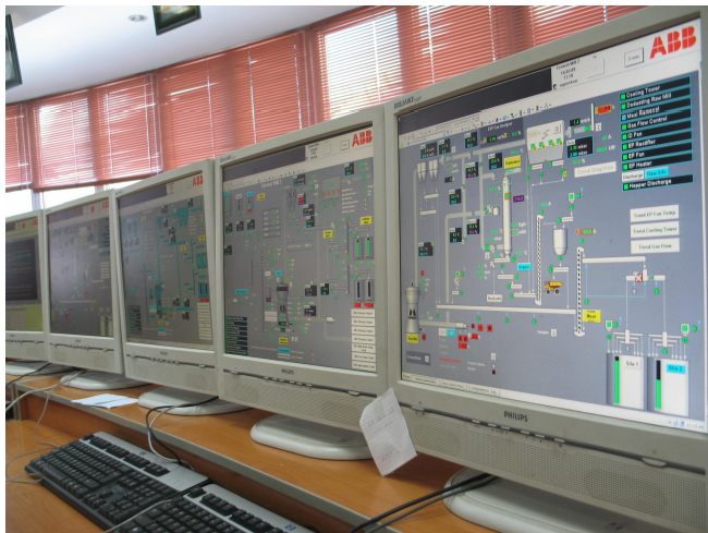
تجهیزات اتاق کنترل
